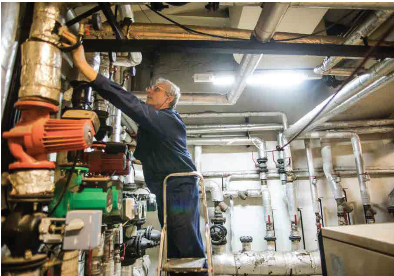
Lilian Chioveanu, 54 ans, électricien, dans l'installation thermique de l'Athénée. « Je travaille ici depuis 16 ans. Nous sommes quatre chauffagistes et quatre électriciens. La seule chose que je changerais de l'Athénée sont toutes les installations qui commencent à vieillir. »
